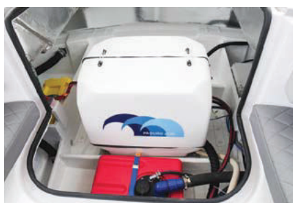
Generator prądu zapewnia niezależność.
